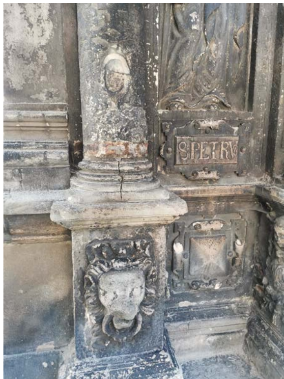
Рис. 4. Ушкодження будівельного каменю фасадної стіни каплиці
