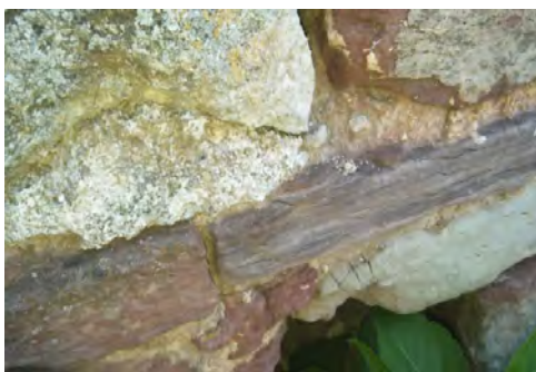
Рис. 9. Руйнування шовного матеріалу, тріщинуватість.
