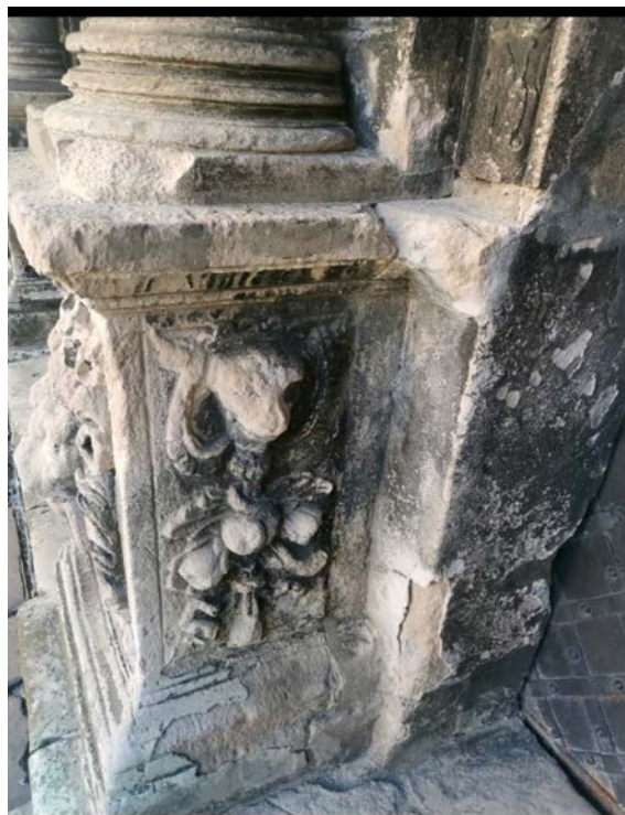
Рис. 5. Фрагменти різного виду ушкоджень будівельного каменю
