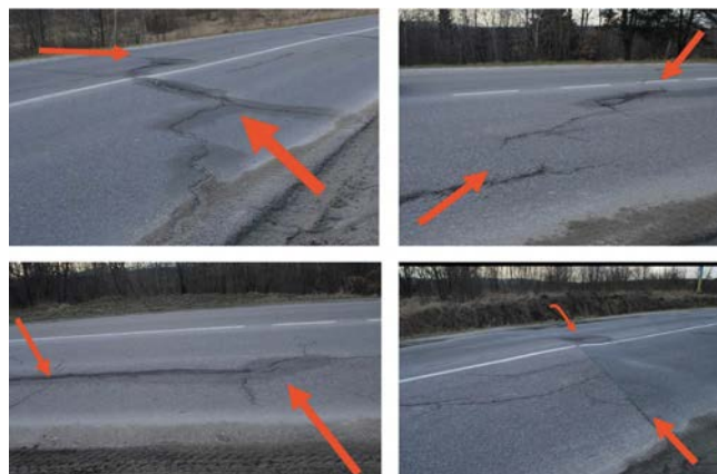
Рис. 6. Тріщини в дорожньому полотні дороги Львів-Трускавець, пов'язані з карстопровальними явищами
