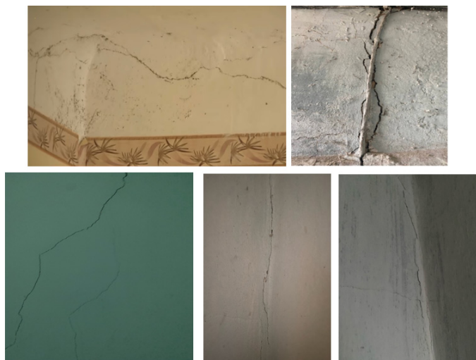
Рис. 7. Тріщини на стелі і стінах будинків мешканців вул. Уляни Кравченко в села Солець (власні світлини)
