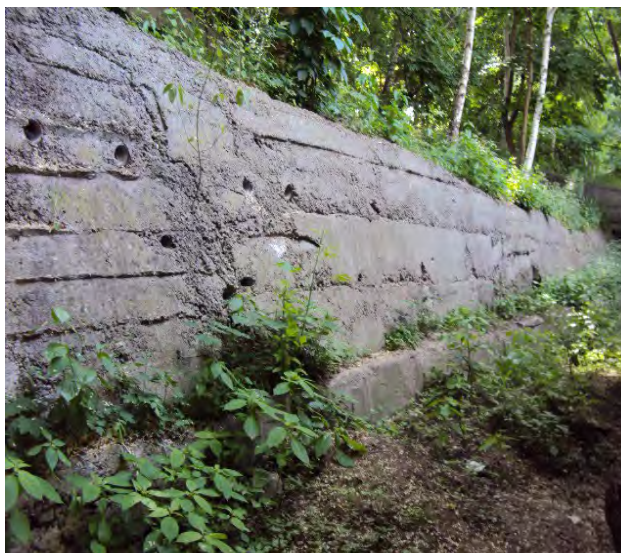
Рис. 6. Підпірна стінка біля підніжжя осувного тіла по вул. Сахарова
