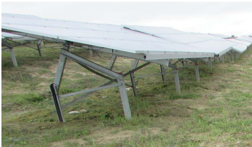
Рис. 4. Ефект затінення – порушення під сонячними панелями інсоляції ґрунтового покриву
