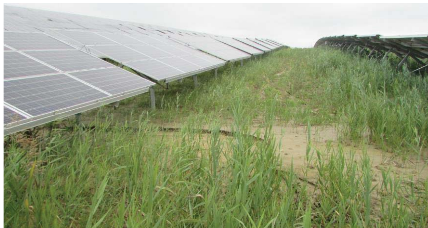
Рис. 7. Прояви точкового ерозійного розмиву концентрованими стоками зливових атмосферних опадів із сонячних панелей
