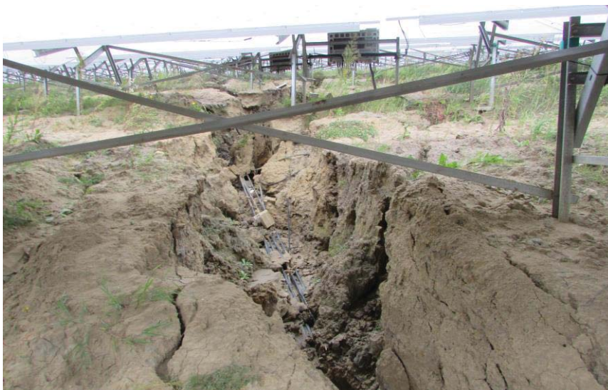
Рис. 9. Прояв глибокого яркового розмиву ґрунтового масиву, в межах якого інстальовано сонячні панелі, іноді до досить значної глибини
