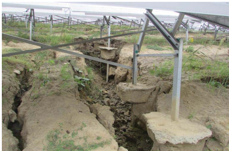
Рис. 10. Ефект змін інженерно-геологічних умов за умов глибокого яркового розмиву ґрунтового масиву, що призводить до радикальної зміни рельєфу під фундаментами, утворення водоройн специфічних форм та різних розмірів, зумовлює втрату опорними несучої здатності
