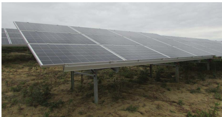
Рис. 3. Ефект «парасолі» сонячних панелей – атмосферні опади не звожують під ними ґрунт
